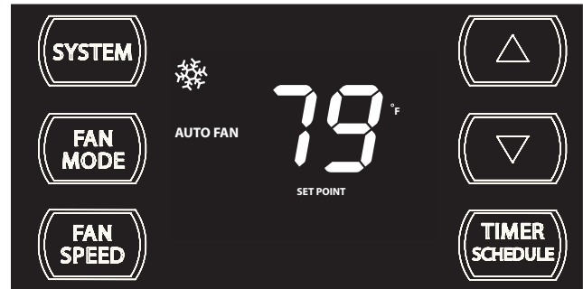
AUTO FAN (No Cooling Demand)
